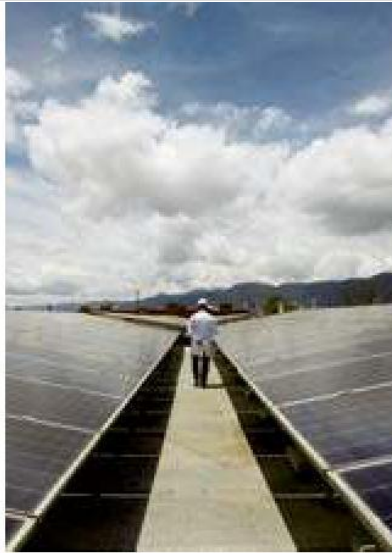
Sopra, un tecnico a Bogotá (Colombia) ispeziona i pannelli solari, uno degli strumenti per creare energia verde.
